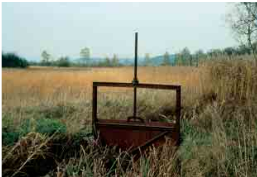
Altes Stauwehr zur Staubbewässerung im Neeracher Ried ZH .
